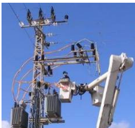
צילום 8: התקנת ציפוי לחוטי הגישור המתחברים לשנאים על עמוד מורכב עם מתגים ושנאים שחישמל מספר עיטי שמש בצמוד למאגר צובא-שורש (צילם עזרה חדד)
